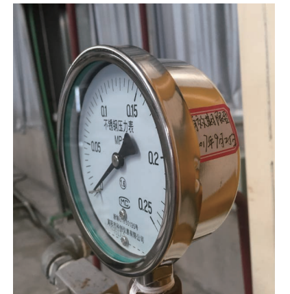
安全装置有效期检查
